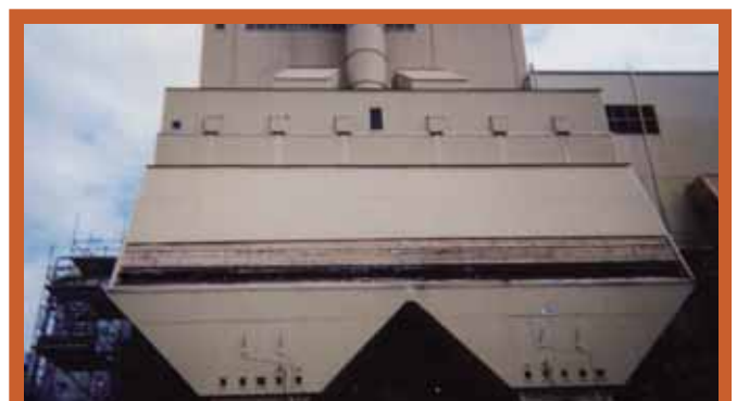
经气体斜向流动技术改进后的除尘器
